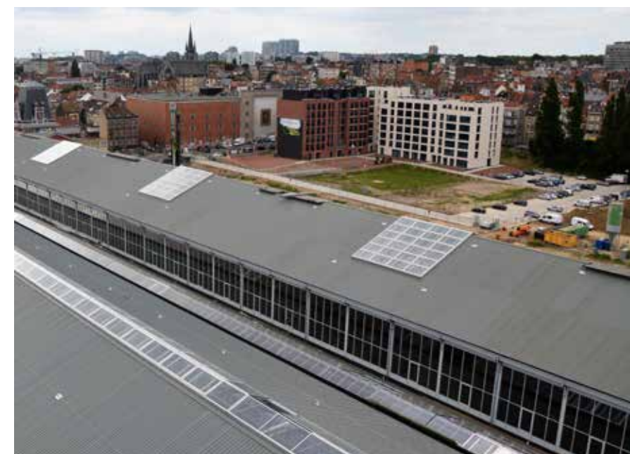
Concrètement, 800 systèmes de désenfumage - autrement dit 2800 m 2 d'éléments ouvrants - sont intégrés dans la toiture en verre.
